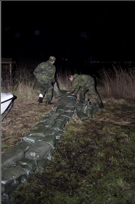
Hjemmeværnet fortsat i gang med at bygge dige ved Kronprins Frederiks Bro og Færgevej.
