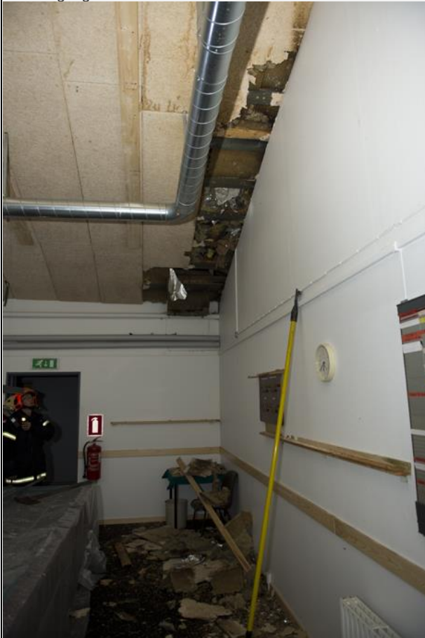
Billardrummet efter branden.
