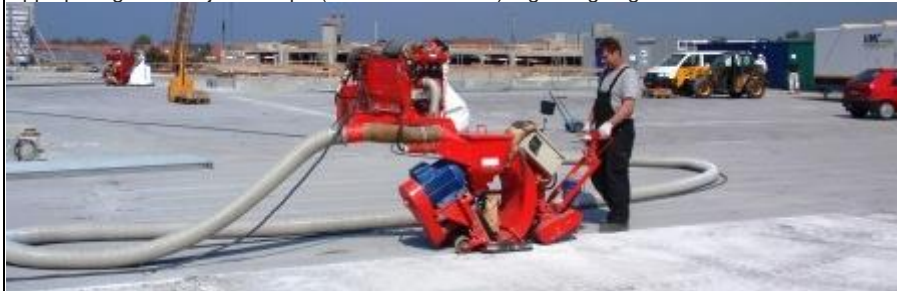
Først er det øverste dæk på parkeringshuset hvor betondækket høvles eller raspes af for at sikre en jævnt underlag med en passende ruhed. Operatøren trækker høvlen efter sig, og maskinen er gennem den store slange forbundet med en stor støvsuger der opsamler det afhøvlede i en stor hvid sæk.
