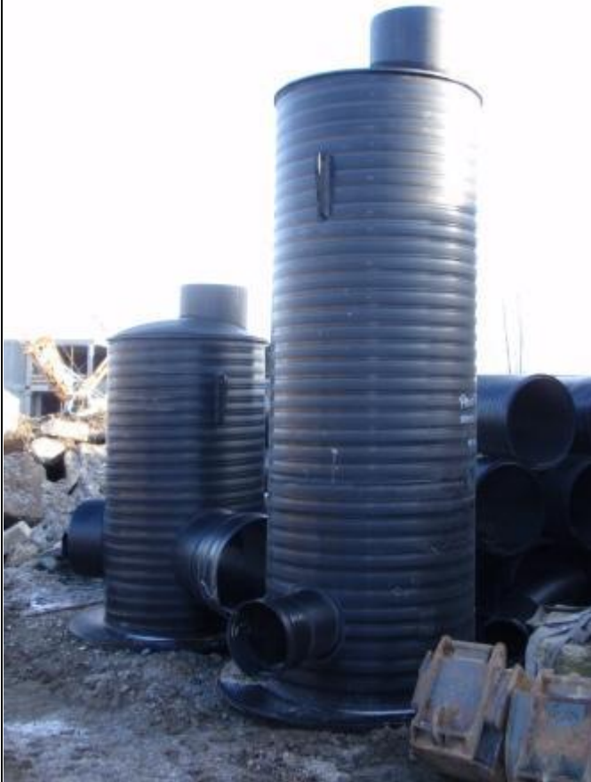
Herunder et par fotos fra det indre af den ny pumpestation.
