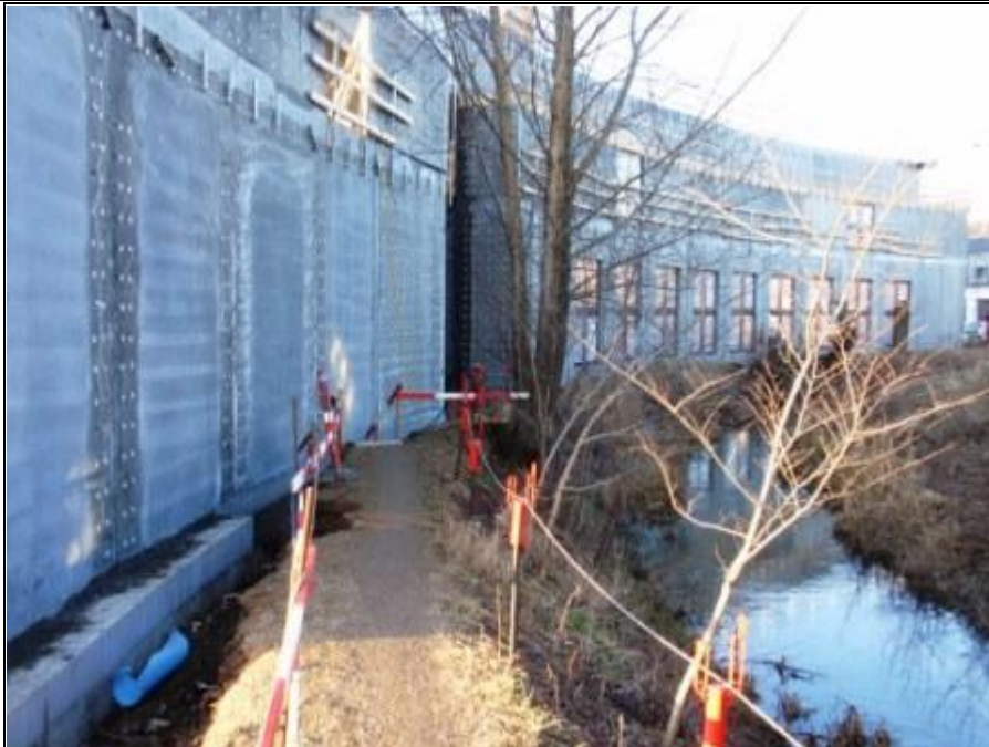
Ud til A.C. Hansensvej ved den gamle og den nye pumpestation og transformere m.m. er der stadig gang i ledningsarbejderne efter at arbejdet ude i selve vejen er afsluttet.
