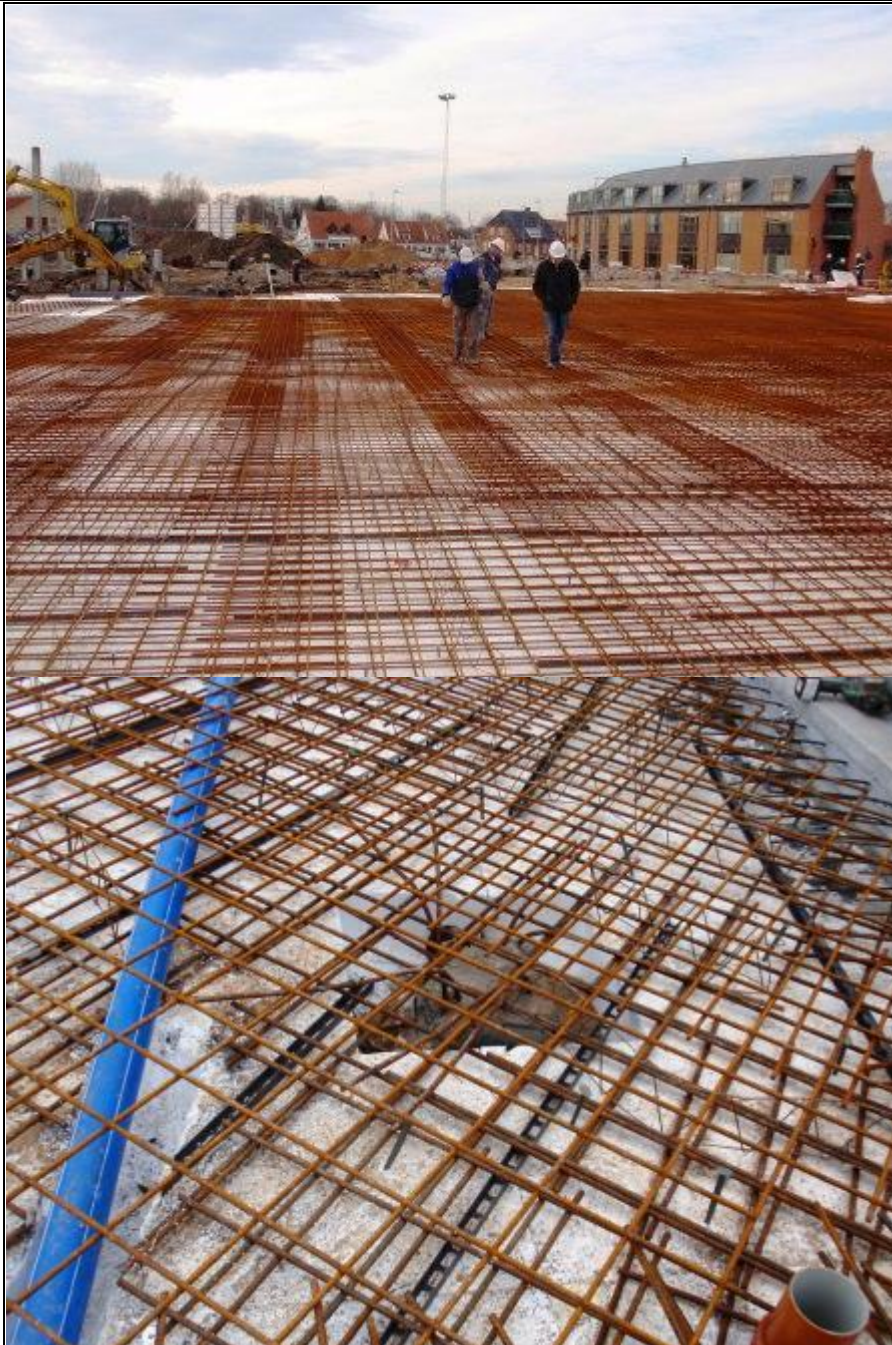
Ved at følge åen (Sillebro Å) rundt ses endnu flere etaper af byggeriet med stadigt pågående funderingsarbejde. Nederste foto viser hvordan en tryklufsanordning knuser det øverste stykke af funderingspælenes beton og fritlægger de armeringsjern der skal støbes sammen med nederste betondæk (som vist ovenfor).
